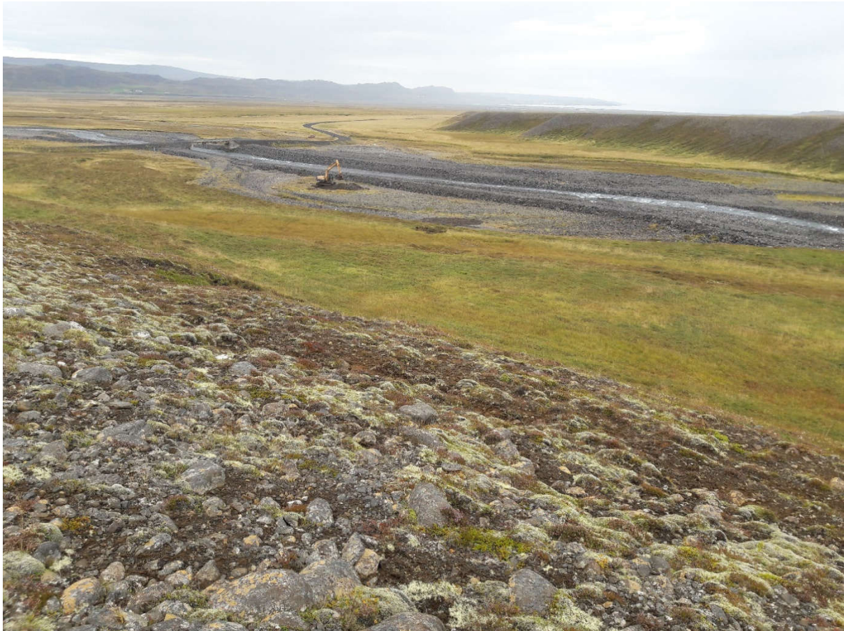
Mynd 3: Horft yfir svæðið þar sem gert er ráð fyrir að staðsetja stöðvarhús og frárennisskurð. Grafa að grafa könnunarholu nr.3 til að kanna gerð og þykkt jarðlaga.
